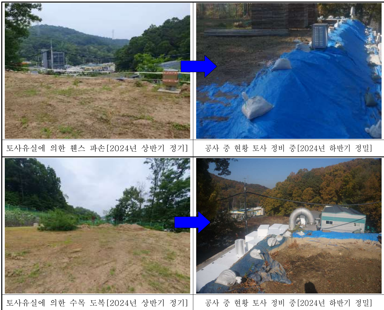
【사진 3.8】 기타 부대시설 손상사진(계속)
